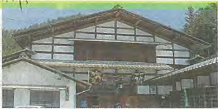
県産材を使った伝統工法で改修される明治座＝岐阜県中津川市で
