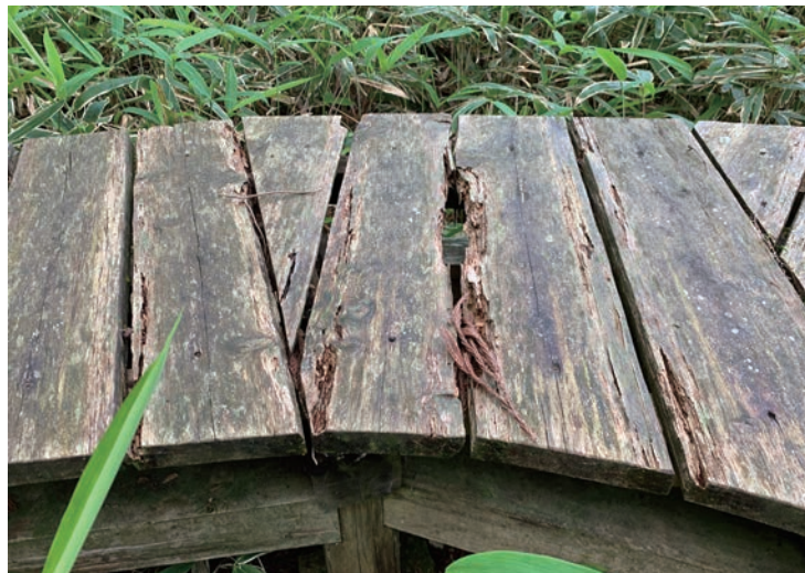
図 3.7-2 デッキの劣化部分
