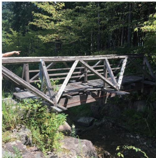
図 3.7-6 人工溪流に架けられていた橋
